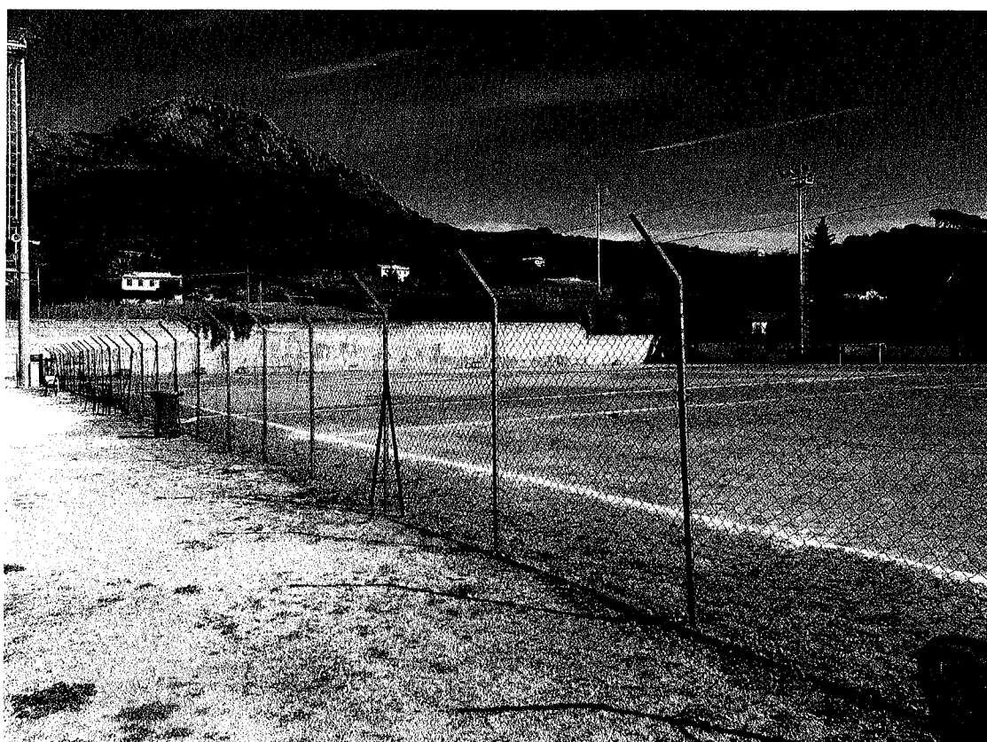
Foto n. 2 – Tratto di Recinzione da sostituire.
